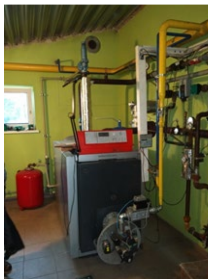
2.11. ATTĒLS: Dobeles novada Mežinieku pamatskolas gāzes apkures katls
