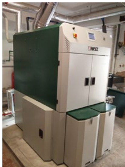
2.12. ATTĒLS: Lejasstrazdu sākumskolas granulu apkures katls
