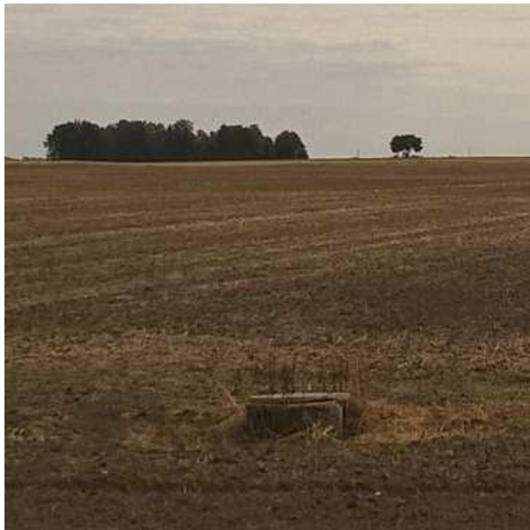
62. attēls "Novecojusī meliorācijas drenāžas aka" (foto P. Grants 16.08.17.)
