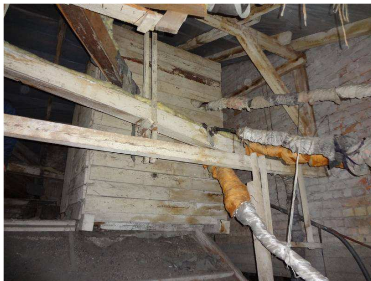
5.4.6. attēls. Penkules pamatskolas apkures sistēmas bēniņu sadale ar nesiltinātiem un daļēji siltinātiem apkures cauruļvadiem
