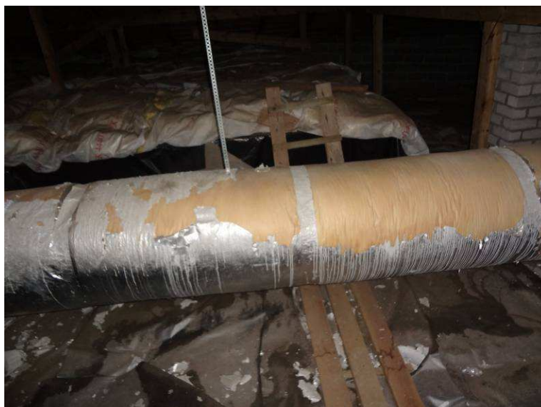
5.2.4. attēls. Dobeles 1. vidusskolas aktu zāles ventilācijas cauruļvadi ar putnu radītiem bojājumiem cauruļvadu izolācijā
