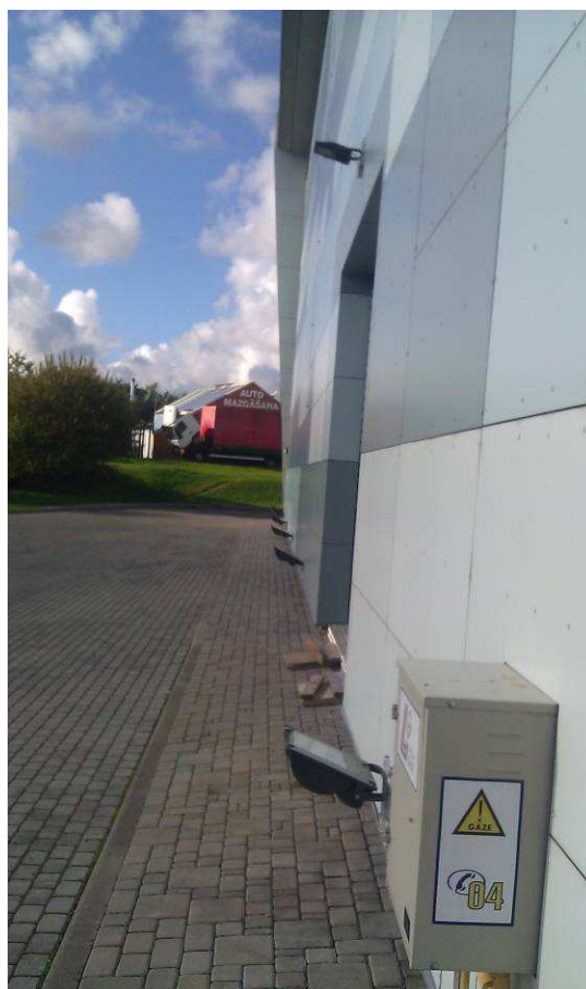
4.2.1. attēls. Dobeles pilsētas sporta hāles fasādes apgaismojums
