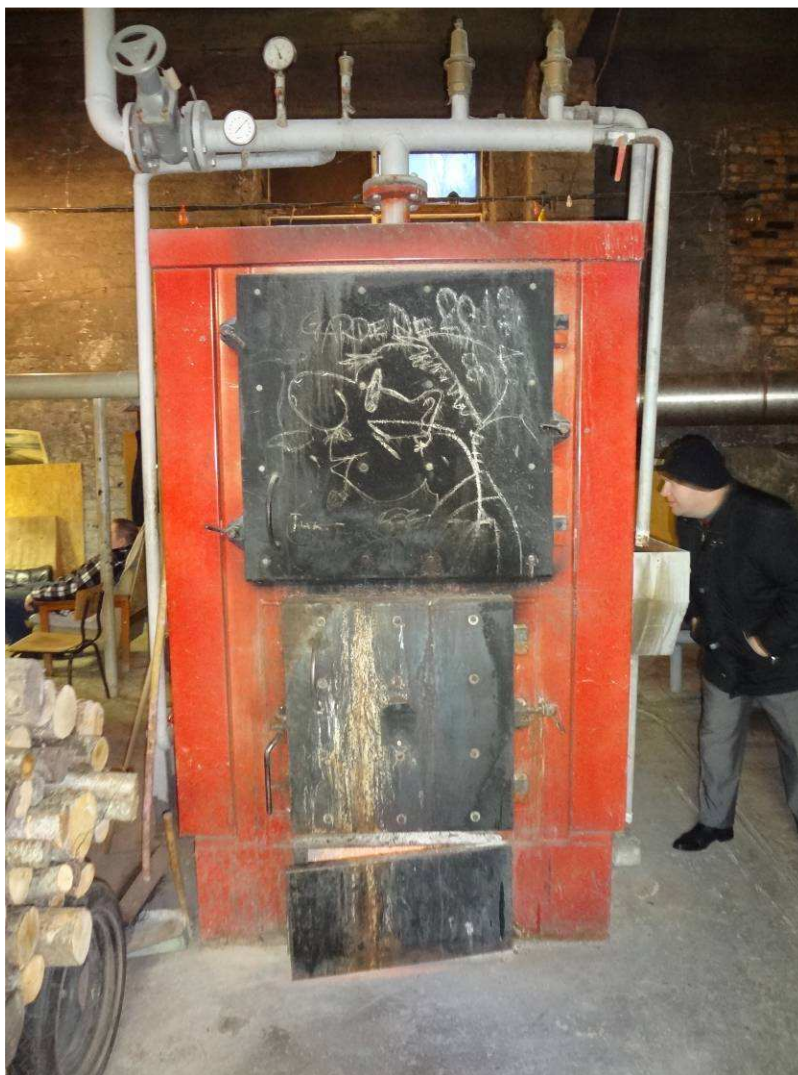
5.3.9. attēls. Gardenes pamatskolas katlu māja ar esošajiem apkures katliem, kuri neatbildīs siltumslodzei pēc siltināšanas (darbosies neefektīvi)
