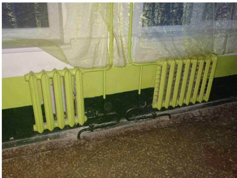
5.3.3. attēls. Gardenes pamatskolas esošie čuguna radiatoru
