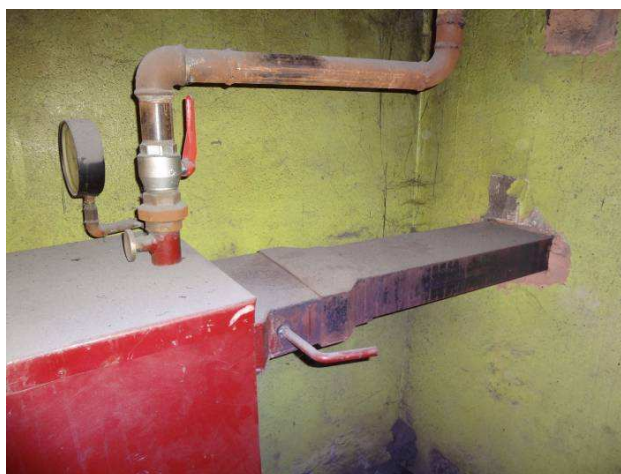
5.4.9. attēls. Penkules pamatskolas vecās skolas ēkas apkures sistēma bez mazā cirkulācijas loka, kas nenodrošina atbilstošu katla ekspluatācijas režīmu, rada kondensātu dūmgāzēs un saīsina apkures katla mūžu
