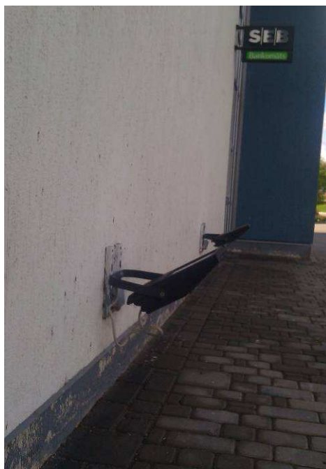
4.2.3. attēls. Dobeles pilsētas sporta halles fasādes apgaismojums
