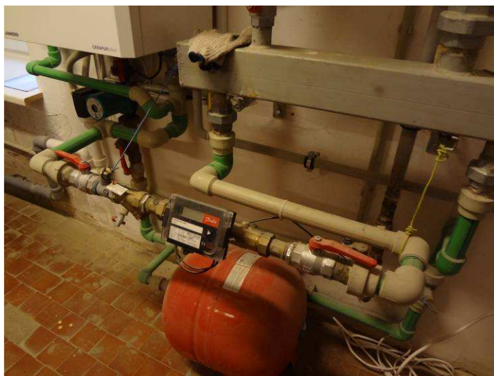
5.5.2. attēls. Kaķenieku PII "Riekstiņš" siltummezgls, ar neatbilstoši nostiprinātu siltummērītāju (rada mērījumu neprecizitāti)
