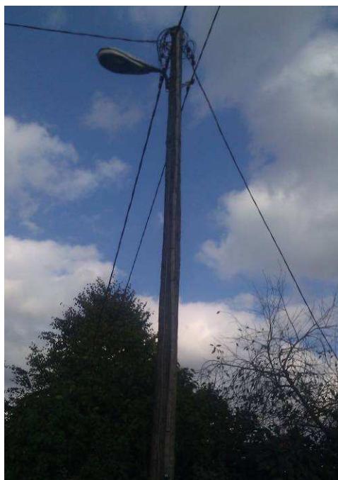
3.13. attēls. Dobeles pilsētas Liepu ielas esošais apgaismojums ar DRL tipa lampām
