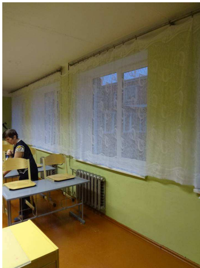
5.3.6. attēls. Gardenes pamatskolas esošie radiatori pamatskolas mācību telpās
