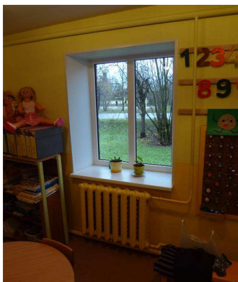
5.4.11. attēls. Penkules pamatskolas vecās skolas ēkas 1. stāva čuguna radiatori (pirmsskolas izglītības grupiņas telpās)
