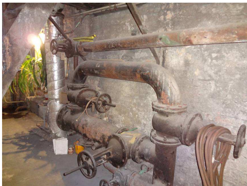
5.3.8. attēls. Gardenes pamatskolas katlu māja ar nesiltinātiem cauruļvadiem
