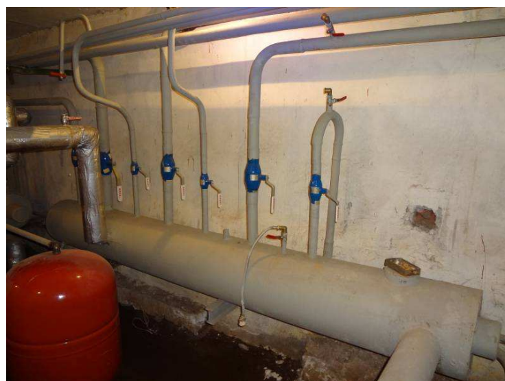
5.3.2. attēls. Gardenes pamatskolas siltummezgls ar nesiltinātiem cauruļvadiem, ar regulācijas armatūru taču bez balansēšanas armatūras
