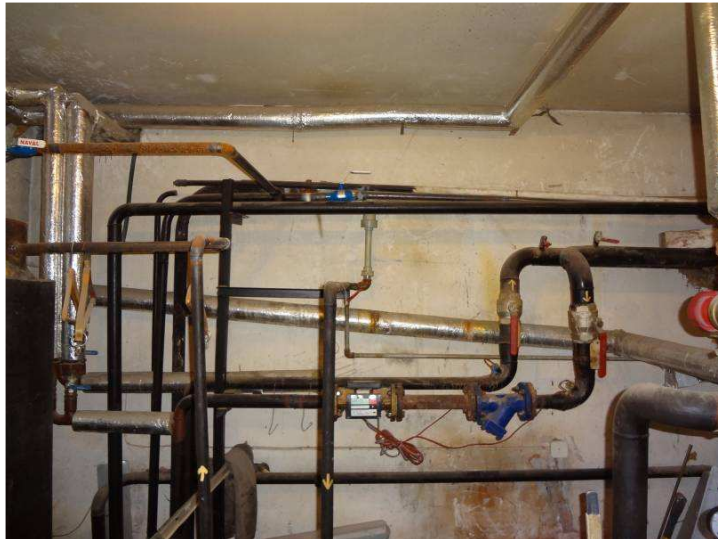
5.2.6. attēls. Dobeles 1. vidusskolas siltummezgls ar nesiltinātiem cauruļvadiem, kā arī bez regulācijas armatūras un balansēšanas armatūras starp dažādiem ēku stāviem, stāvvadiem
