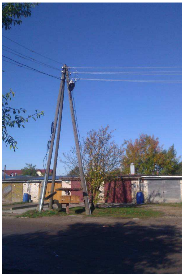
3.4.4. attēls. Krimūnas. Ceriņu ciema esošais nolietotais apgaismojums. Teritorija, kurā ieteicams uzstādīt apgaismojumu satiksmes un publiskās telpas drošības apsvērumu dēļ.
