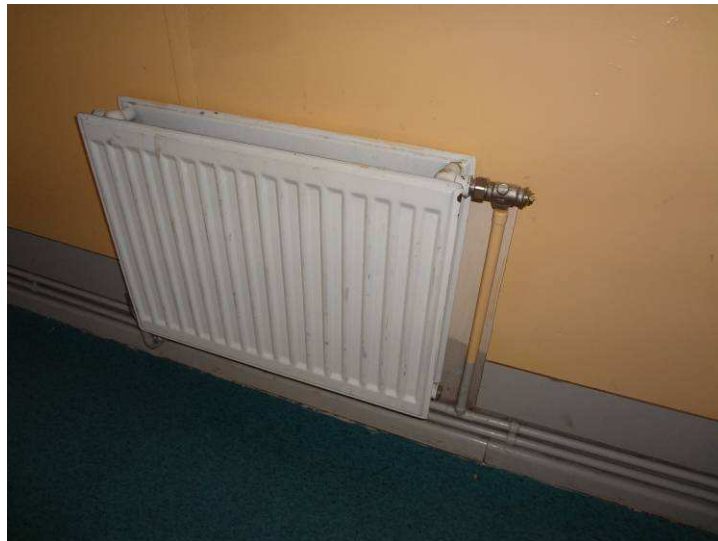
5.2.1. attēls. Dobeles 1. vidusskolas 4. stāva radiatori ar termoregulatoriem, kas nav piemēroti skolas telpām (mehāniski nepietiekoši izturīgi, nolauzti, noskrūvēti)
