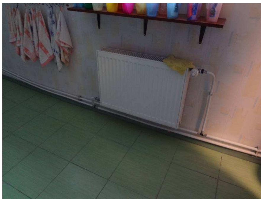
5.5.4. attēls. Kaķenieku PII "Riekstiņš" radiatori ar termoregulatoriem, kas nav piemēroti skolas telpām (mehāniski nepietiekoši izturīgi)
