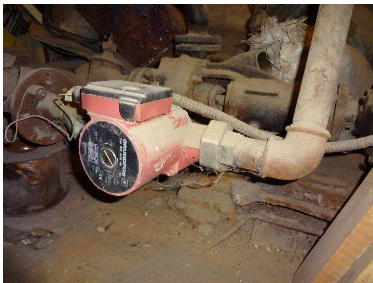
5.4.12. attēls. Penkules pamatskolas vecās skolas ēkas cirkulācijas sūknis, kas uzstādīts pārāk mazjaudīgs
