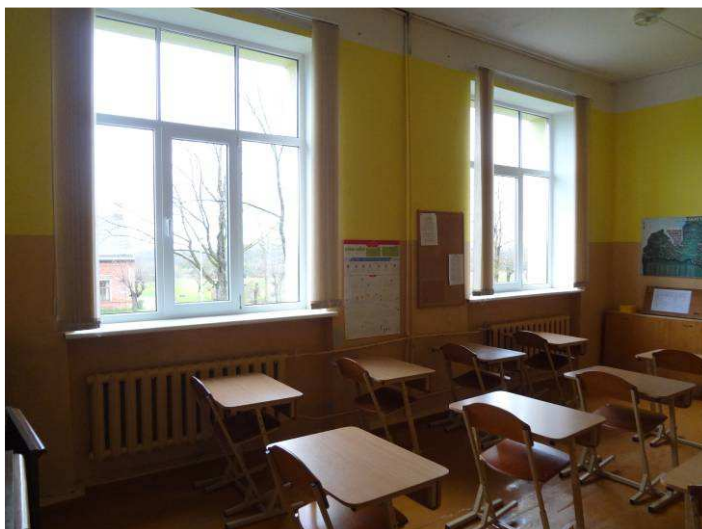
5.4.2. attēls. Penkules pamatskolas mācību telpas ar čuguna radiatoriem un viencauruļu apkures sistēmu
