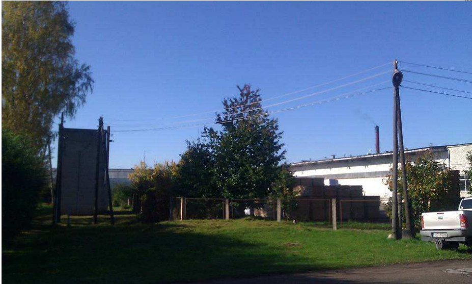
3.4.2. attēls. Krimūnas. Ceriņu ciema esošais nolietotais apgaismojums Teritorija, kurā ieteicams uzstādīt apgaismojumu satiksmes un publiskās telpas drošības apsvērumu dēļ.
