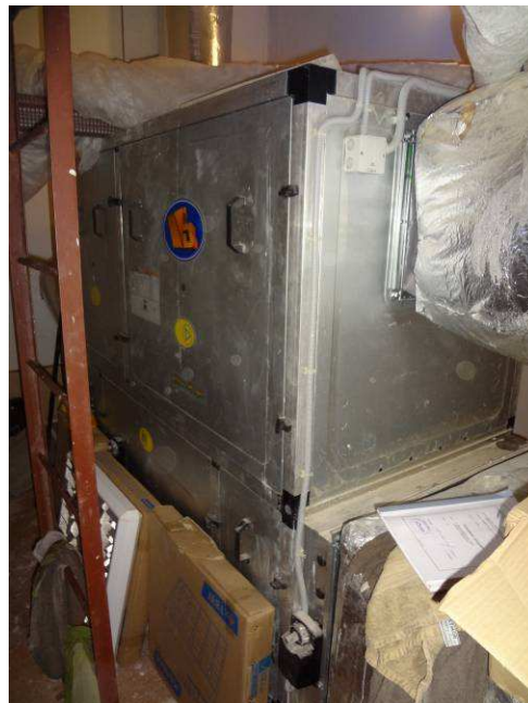
5.2.3. attēls. Dobeles 1. vidusskolas aktu zāles ventilācijas agregāts, kas uzstādīts neatbilstošs aktu zālei - ar pārāk lielu gaisa plūsmu, kas rada gaudošanu un paaugstinātu gaisa kustības ātrumu
