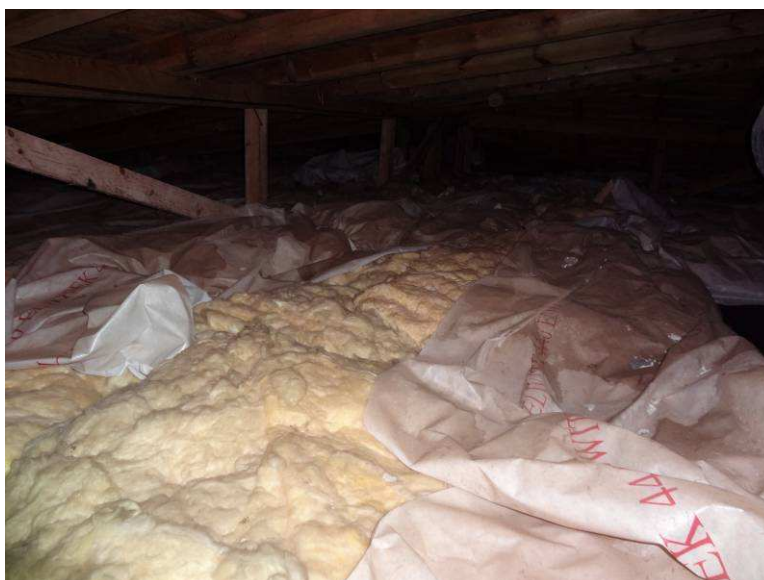
5.2.5. attēls. Dobeles 1. vidusskolas bēniņu pārsegumu siltinājums, ar bojātu kondensācijas plēves pārklājumu un samirkušu minerālvates izolāciju
