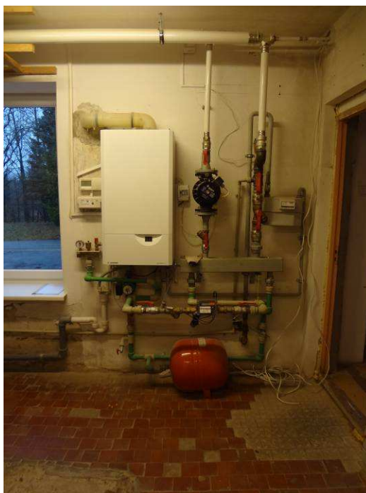
5.5.3. attēls. Kaķenieku PII "Riekstiņš" siltummezgls ar Junkers gāzes apkures katlu un pārāk jaudīgu ūdens cirkulācijas sūkni
