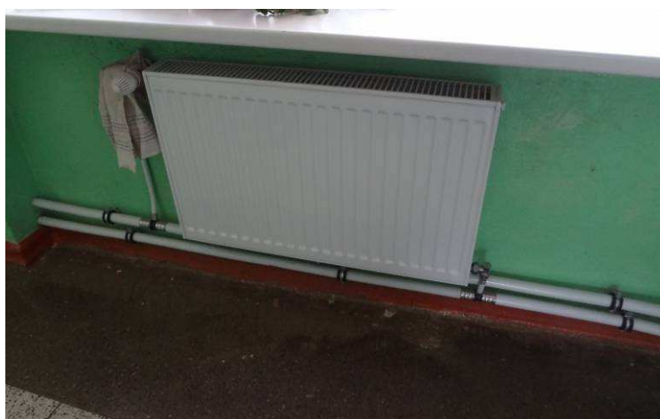
5.1.2. attēls. Annenieku pamatskolas radiatori ar termoregulatoriem, kas nav piemēroti skolas telpām (mehāniski nepietiekoši izturīgi)
