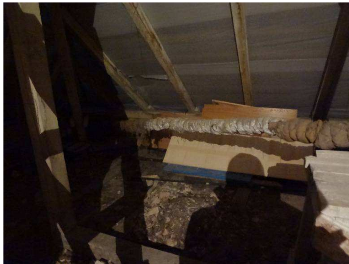
5.4.5. attēls. Penkules pamatskolas bēniņu telpas ar nesiltinātiem un daļēji siltinātiem apkures cauruļvadiem, kā arī nepietiekami bēniņu pārsegumu siltinājumu (izdedžu kārta)
