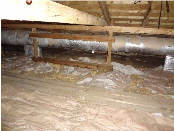
5.2.2. attēls. Dobeles 1. vidusskolas bēniņu pārsegumu siltinājums, ar bojātu kondensācijas plēves pārklājumu un samirkušu minerālvates izolāciju, kā arī putnu radītiem bojājumiem ventilācijas cauruļvadu izolācijā
