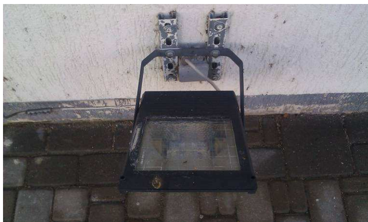
4.2.4. attēls. Dobeles pilsētas sporta halles fasādes apgaismojums
