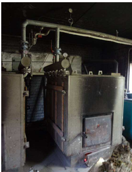
5.4.3. attēls. Penkules pamatskolas katlu mājas esošie apkures katli
