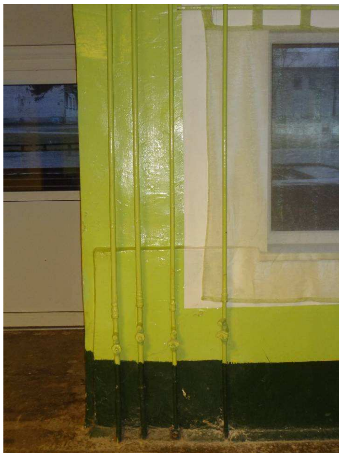
5.3.4. attēls. Gardenes pamatskolas 1. stāva stāvvadi ar bijušām balansēšanas vārstu montāžas vietām
