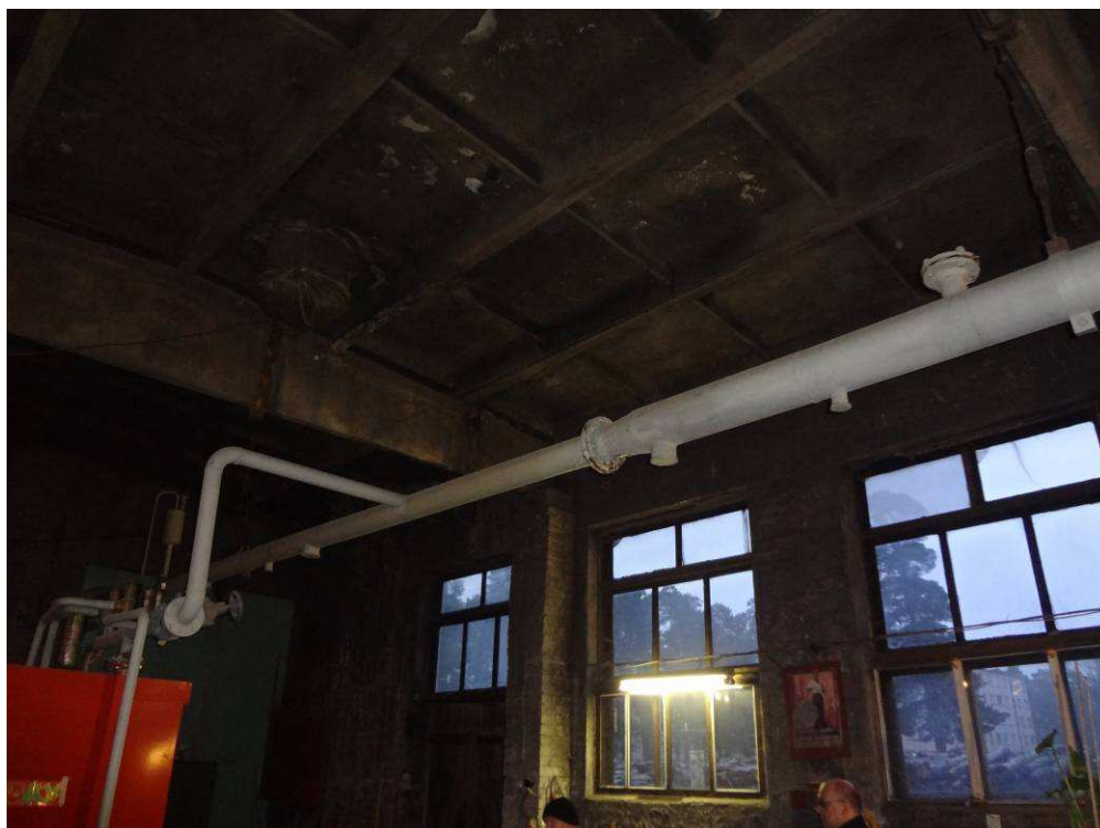
5.3.7. attēls. Gardenes pamatskolas katlu māja ar nesiltinātiem cauruļvadiem
