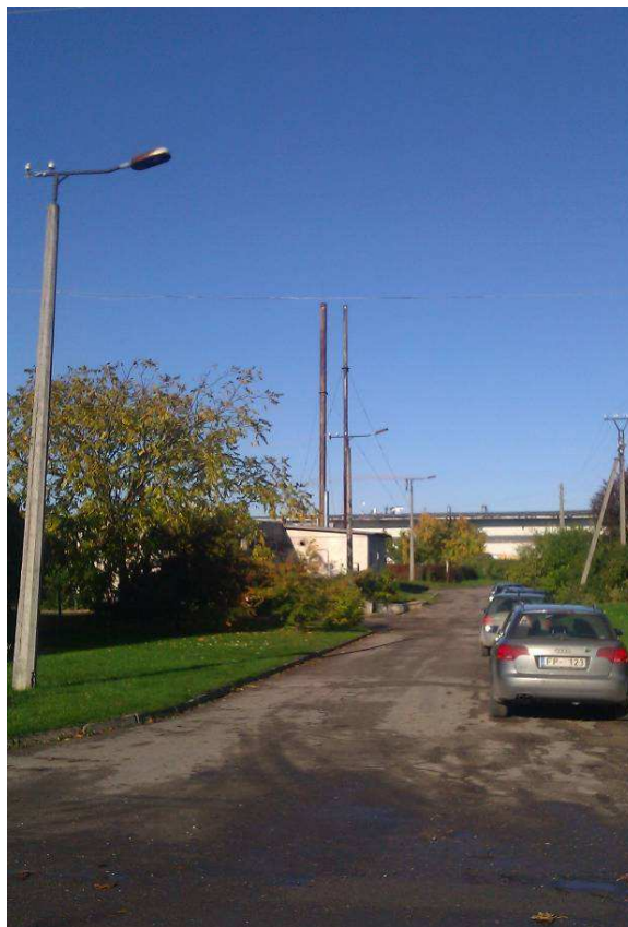
3.4.5. attēls. Krimūnas. Ceriņu ciema esošais nolietotais apgaismojums Teritorija, kurā ieteicams uzstādīt apgaismojumu satiksmes un publiskās telpas drošības apsvērumu dēļ.
